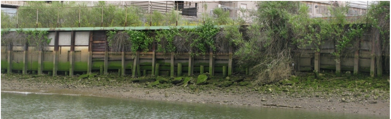
Hình 3 Vách ngăn bằng gỗ của Cảng Seattle ở phía Bắc Cơ Sở.
