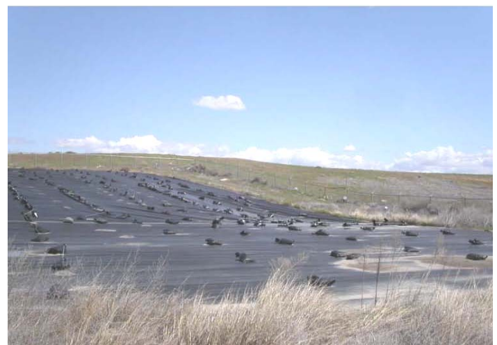
Foto Cortesía de AMEC Cubierta Temporal en la Zona B del Relleno Sanitario
