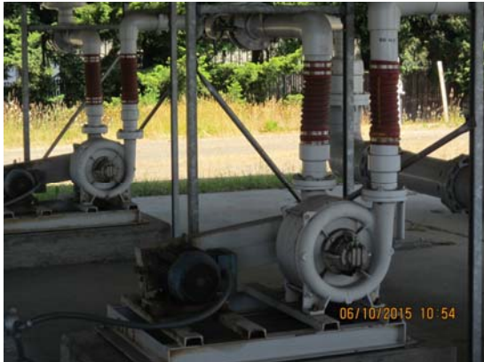
Landfill Gas Blowers
