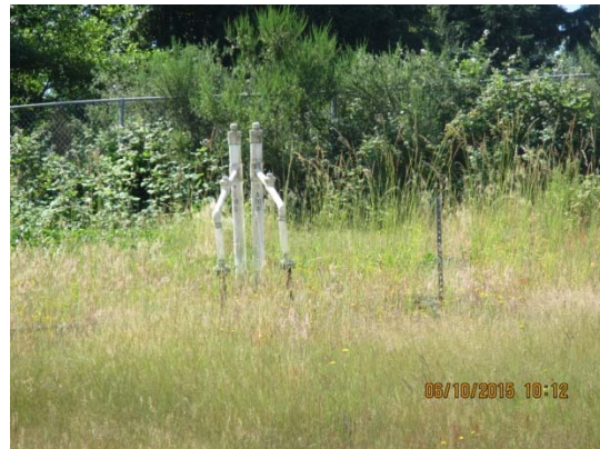
Landfill Gas Wells
