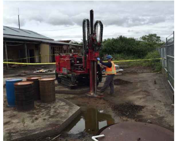
Trabajadores instalando un barreno temporero para tomar muestras de suelo y agua subterránea utilizando una sonda de empuje en el antiguo patio de tanques de almacenamiento. Foto por David Coles.
