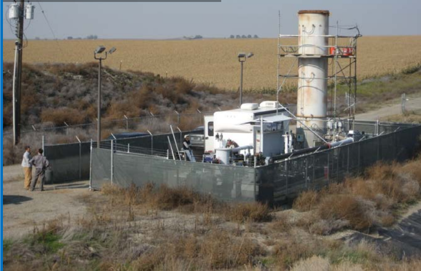
MSW landfill flare
