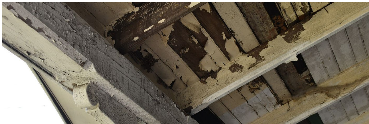
Figura 10: La pintura a base de plomo puede ser un problema si esta se despega o agrieta así. Crédito de foto: Ich n Wikimedia Commons.
